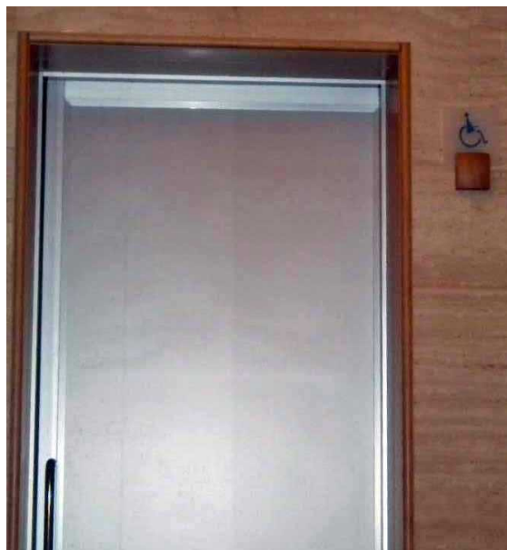
トイレの扉・障害者にとって開けにくい扉でした。
