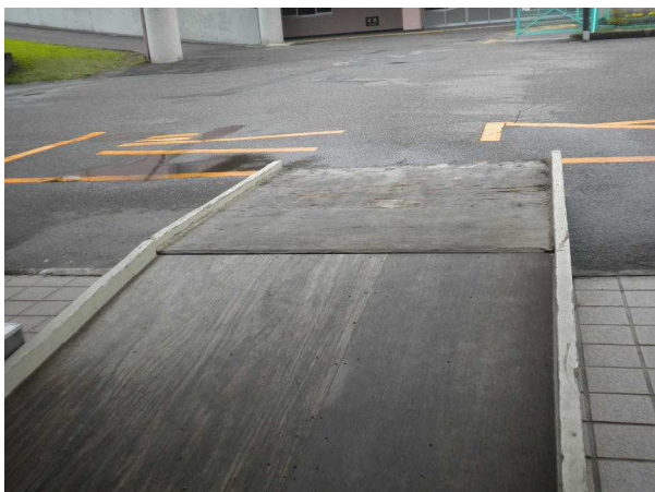
①玄関に設置されたバスに乗るスロープ
