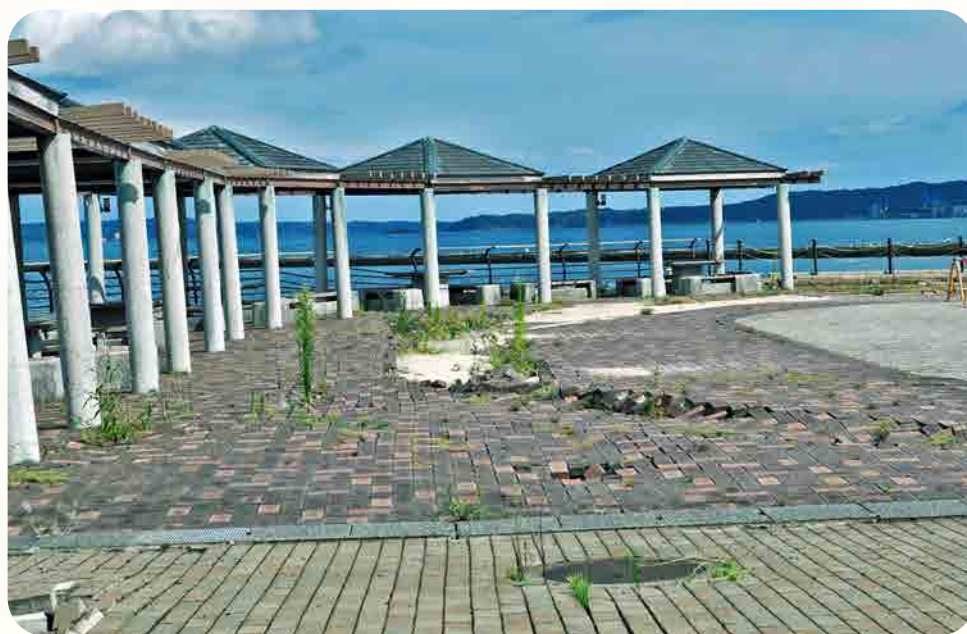
海を見ながらの、飲食・休憩場所が地割れで破損
