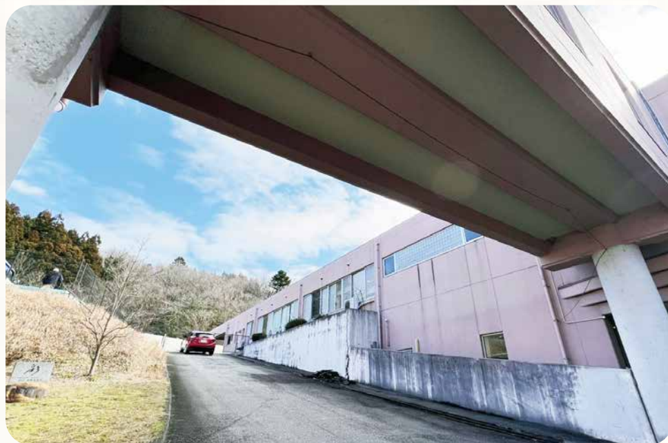
能登半島地震で破損している渡り廊下
