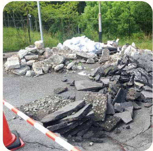
正面玄関のアスファルトのひび割れ
