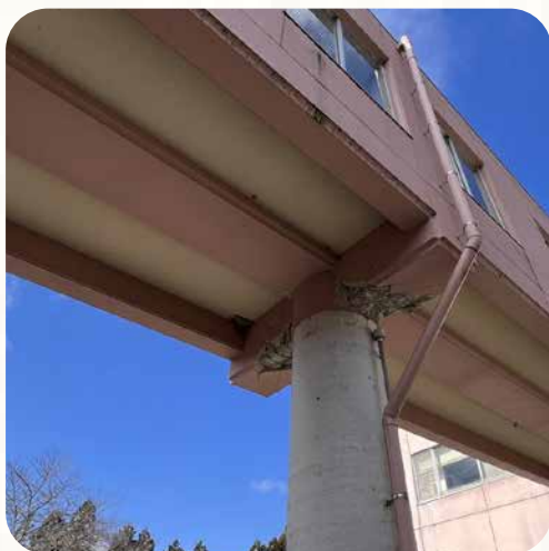
渡り廊下の倒壊
