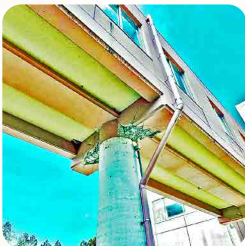
渡り廊下の破損
