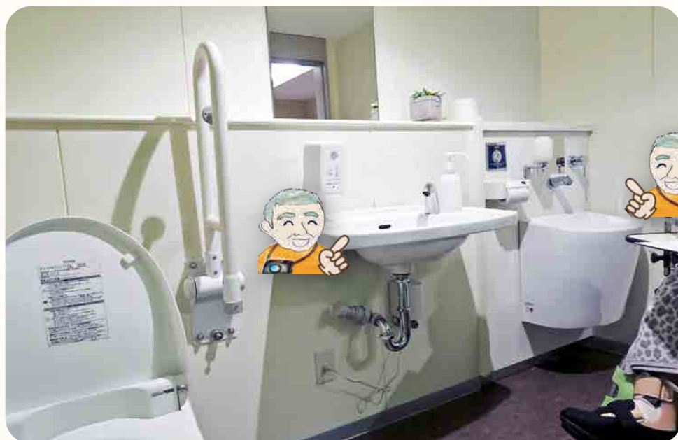
左側は洗面台の高さ：80cm 右側はオストメイト洗浄用
