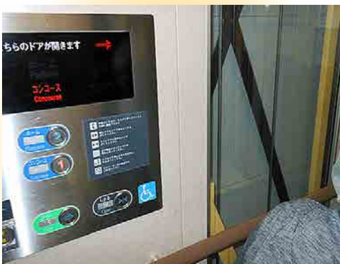
③ エレベーター操作ボタン
