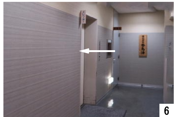
2階のエレベーター
