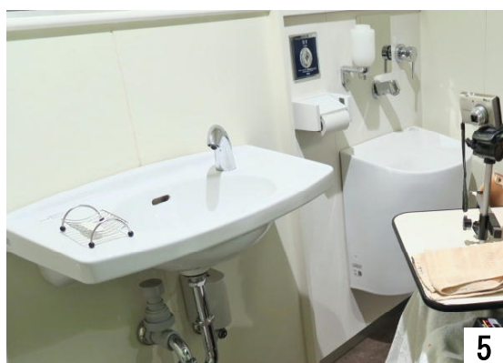
洗面台、汚物洗い槽
