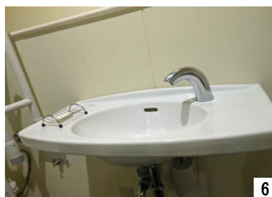
自動給水の洗面台
