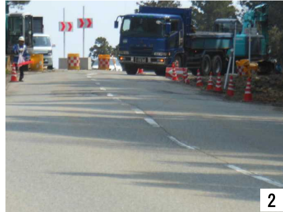
2 工事用車両が通り危険。
