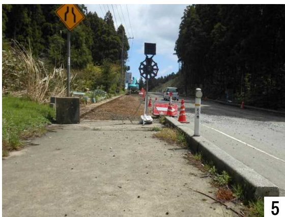
5 歩道が掘り起こされています。
