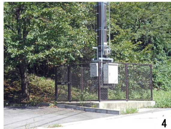
歩道の横に建っているドコモのアンテナ
