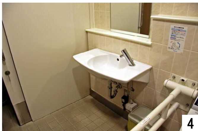
自動給水の洗面台
