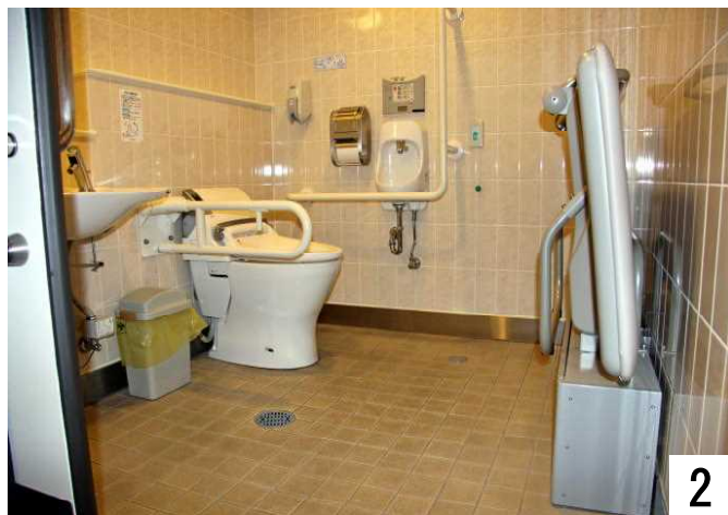
入り口におむつ交換台。車いすの出入りに障害。
