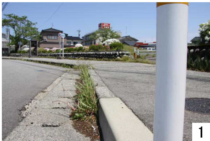
小島橋バス停近くの段差がある歩道
