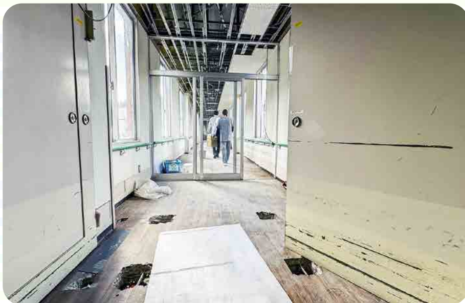
元日の地震で崩落した渡り廊下
