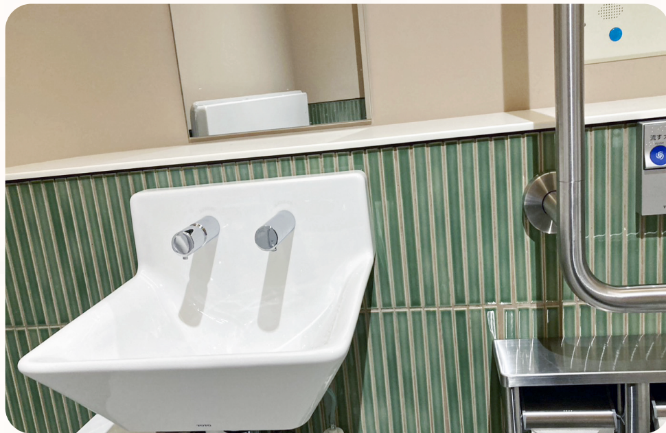
自動給水の手洗い場
