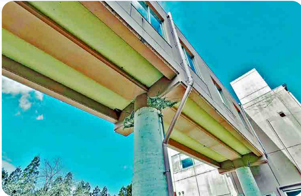
令和6年能登半島地震で破損・青山彩光苑渡り廊下
